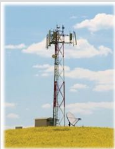
衛星バックホール用地球局を設置した MNO基地局
