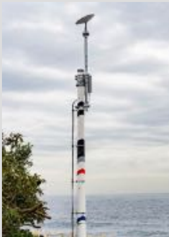
Starlink地球局アンテナを設置した基地局タワー (KDDI発表資料より)
